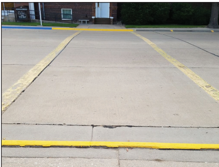
NO ADA CURB CUTS
